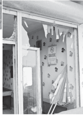
İlçe merkezinde de hissedilen patlamanın etkisiyle Karabulak köyündeki bazı ev ve iş yerlerinin camları kırıldı.
