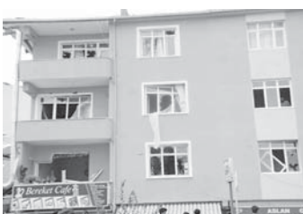
Patlamanın şiddetiyle çevredeki bazı binalar bu hale geldi.
