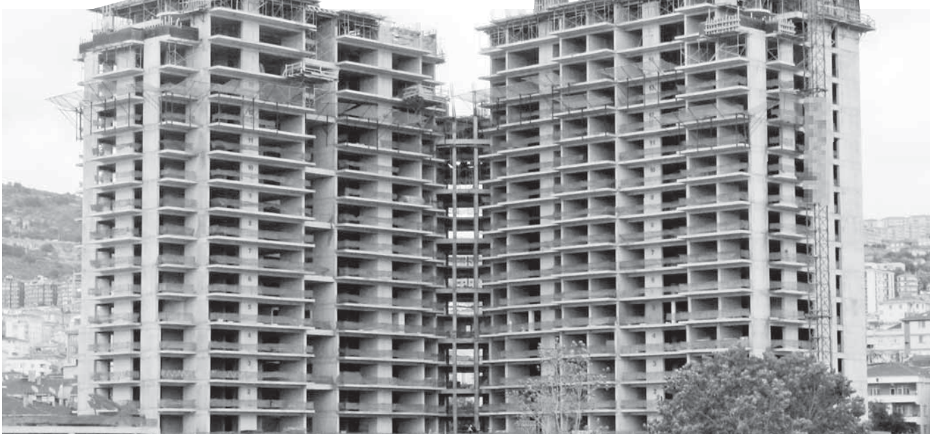
31 Mayıs 2014 tarihinde Kartal’da bir inşaatın yapımı sırasında iskelenin çökmesiyle 3 işçi hayatını kaybetmişti.
