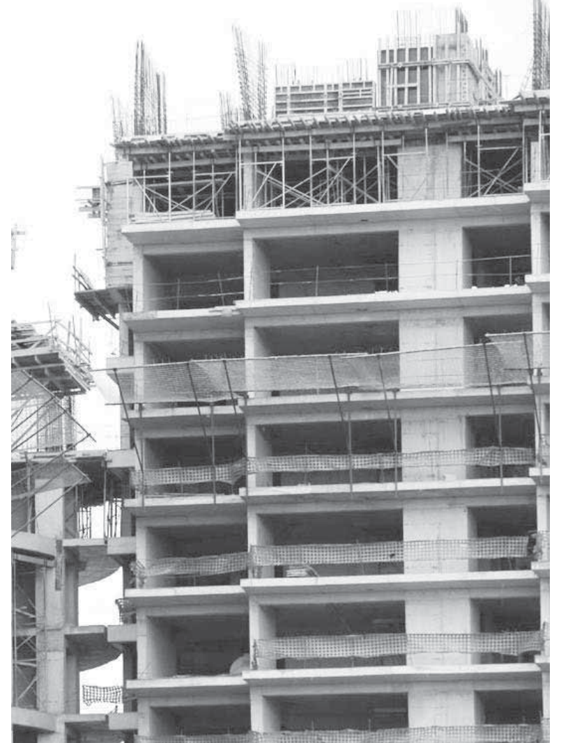
Kartal'da 16 katlı inşaatın en üst katında bulunan iskelenin çökmesi sonucu 3 işçi hayatını kaybetmişti.
