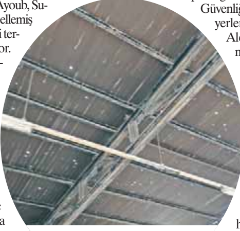
Havan topları opera binasının tavanında delikler açtı.
