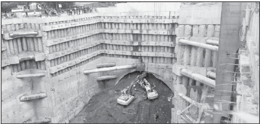
2 Kasım 2018 tarihinde inşaat faaliyeti devam eden Dudullu-Bostancı metro aktarma istasyonunda göçük meydana gelmiş, iki güvenlik görevlisi yaşamını yitirmişti.
